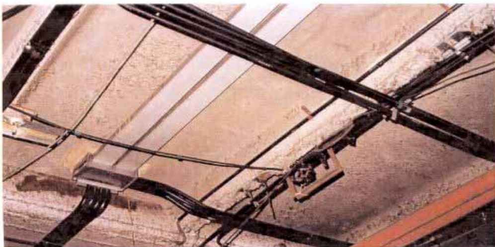
Obr. 3/V – nástřik azbestu – LIMPET – nedopatřením aplikován i na betonovou desku
