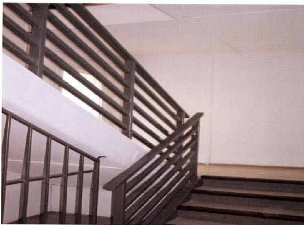
Obr. 25/V - obkladové desky a obložení schodnic schodiště materiálem obsahujícím azbest
