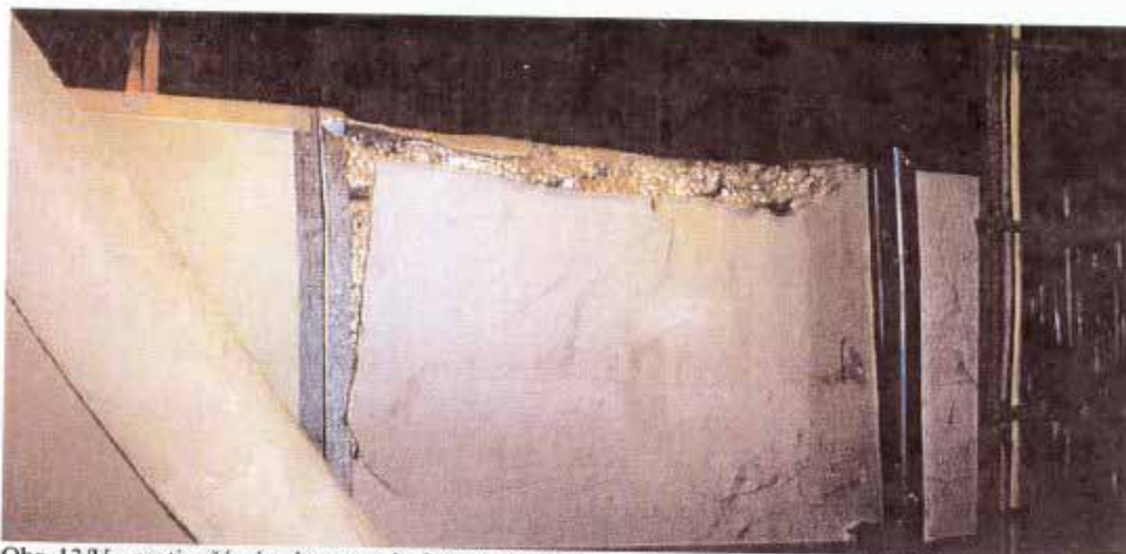
Obr. 13/V - protipožární ochrana vzduchotechnického potrubí azbestocementovými deskami - silně poškozeno
