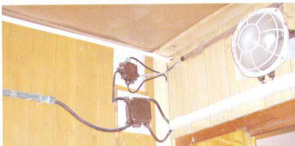
Obr. 30/V - Objekt z unimobuněk - azbestové izolační podkladové destičky pod elektroinstalacemi
