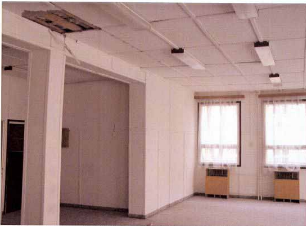
Obr. 24/V – dřevostavba – podhledové desky, příčky a obklad sloupů z materiálu obsahujícího azbest, vnitřní azbestocementová obkladová deska na obvodovém plášti.
