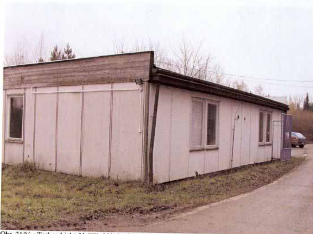
Obr. 21/V – Tesko objekt. Vnější obkladová azbestocementová deska na obvodovém plášti
