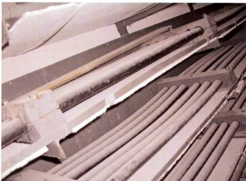
Obr. 19/V – kabely odděleny azbestocementovými deskami, kraje neošetřené, v prachu na kabelech azbest
