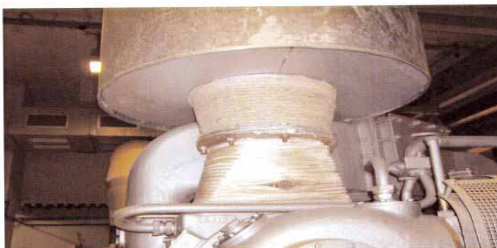
Obr. 31/V - výfukové potrubí dieselařegátu je obaleno azbestovou izolační šňúrou
