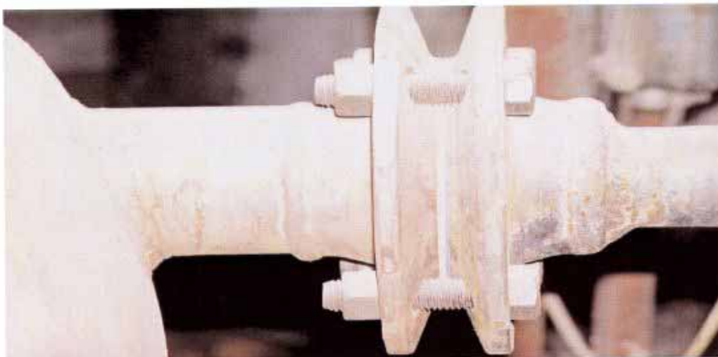
Obr. 29/V - detail těsnění příruby teplovodního potrubí. Ploché azbestové těsnění klingerit.
