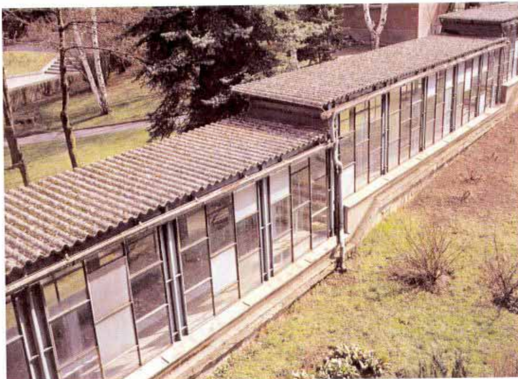
Obr. 26/V – azbestocementová střešní krytina z vlnitého eternitu
