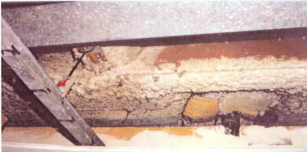
Obr. 2/V – nástřik azbestu – LIMPET – zkorodovaná ocelová konstrukce
