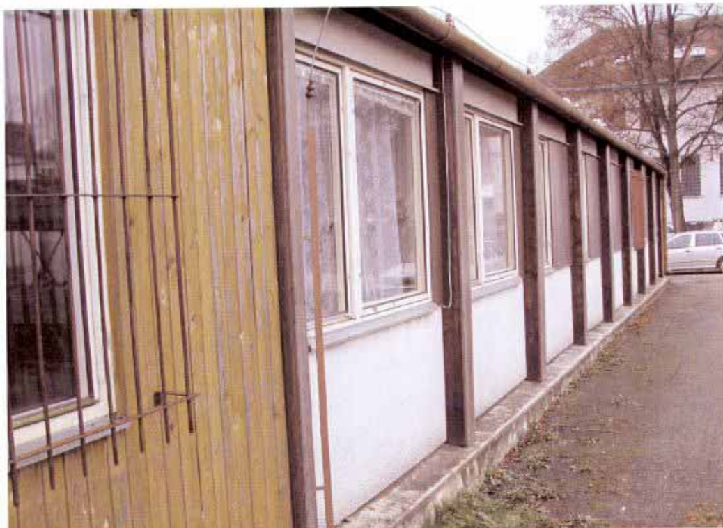
Obr. 22/V – unimobuňky původní – vnější obkladová azbestocementová deska na obvodovém plášti
